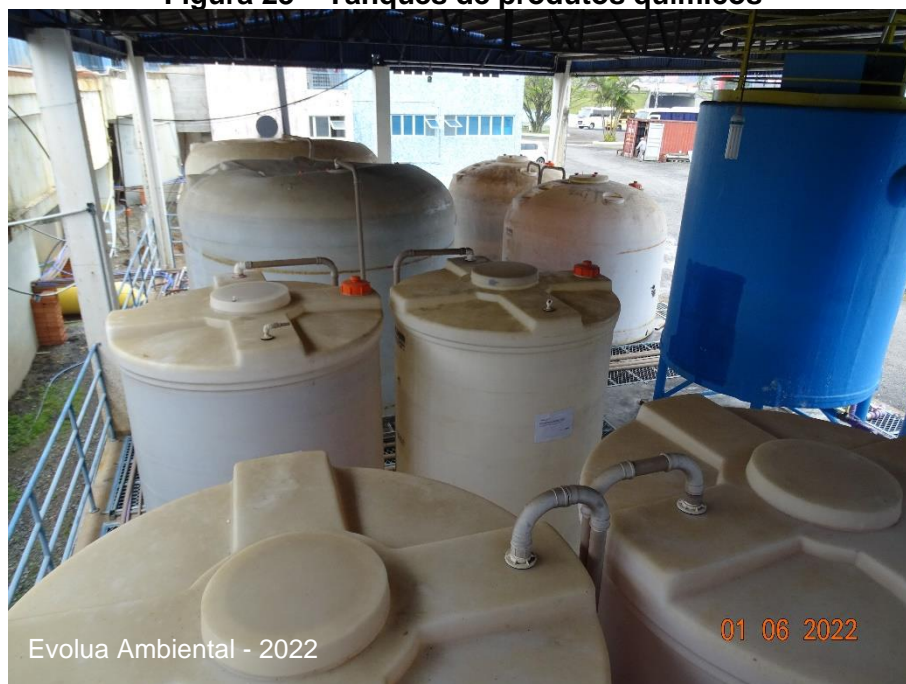
Figura 23 – Tanques de produtos químicos
