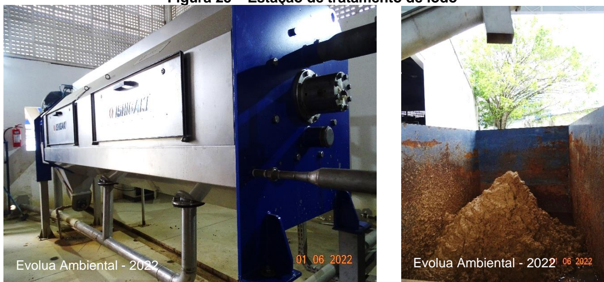
Figura 25 – Estação de tratamento de lodo
