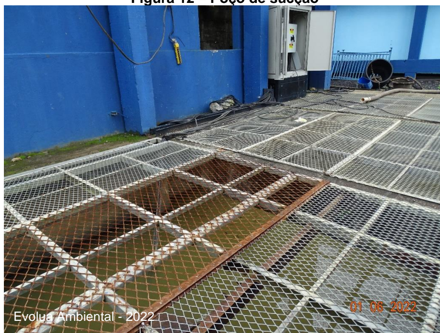
Figura 12 – Poço de sucção
