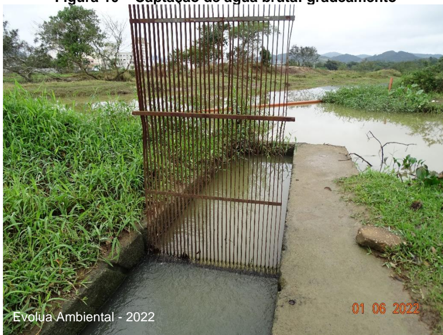
Figura 10 – Captação de água bruta: gradeamento
