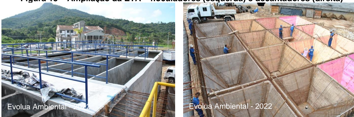
Figura 15 – Ampliação da ETA – flocculadores (esquerda) e decantadores (direita)
