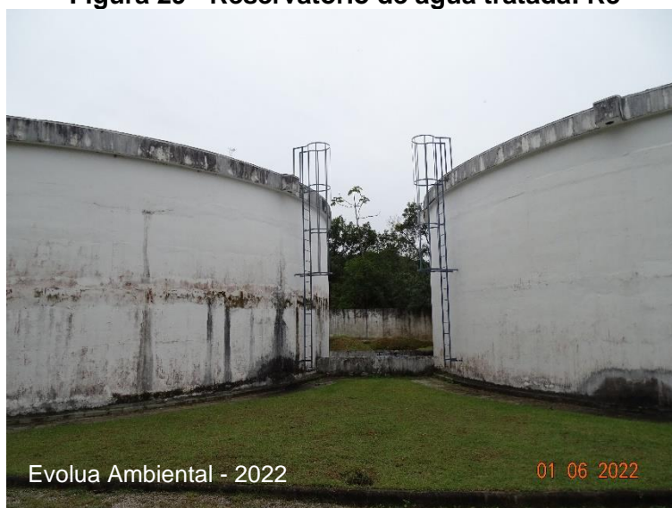
Figura 29 - Reservatório de água tratada: R3
