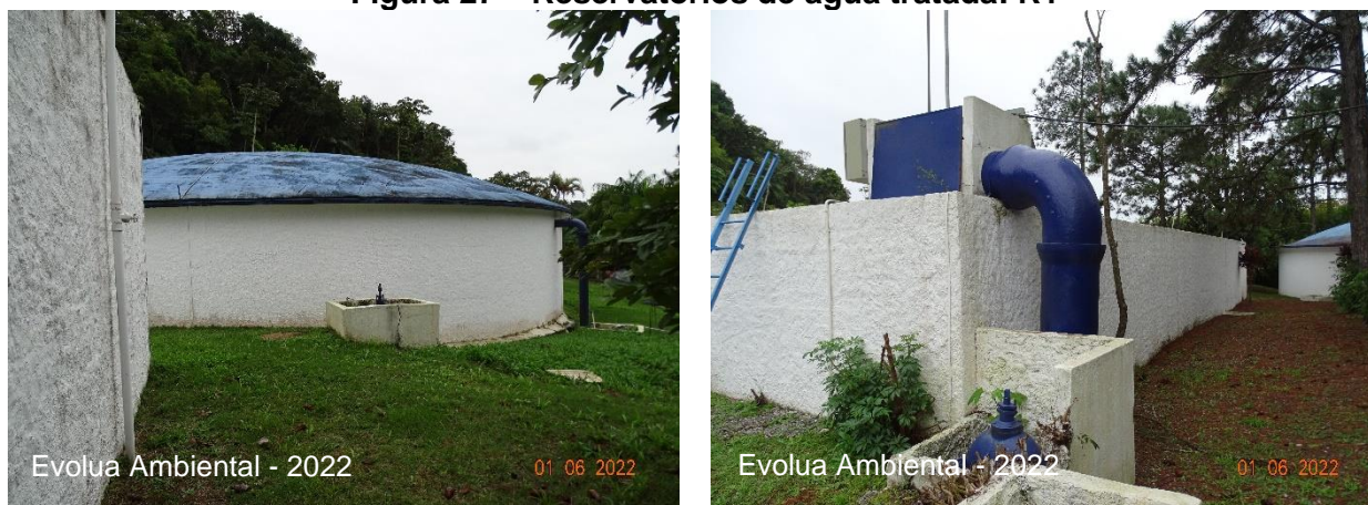
Figura 27 – Reservatórios de água tratada: R1
