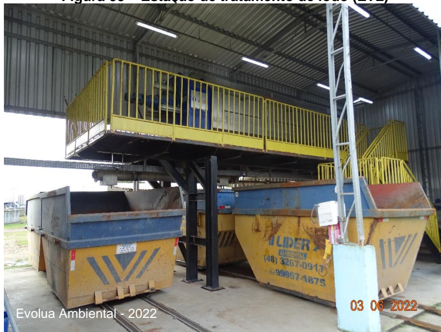
Figura 53 – Estação de tratamento de lodo (ETL)
