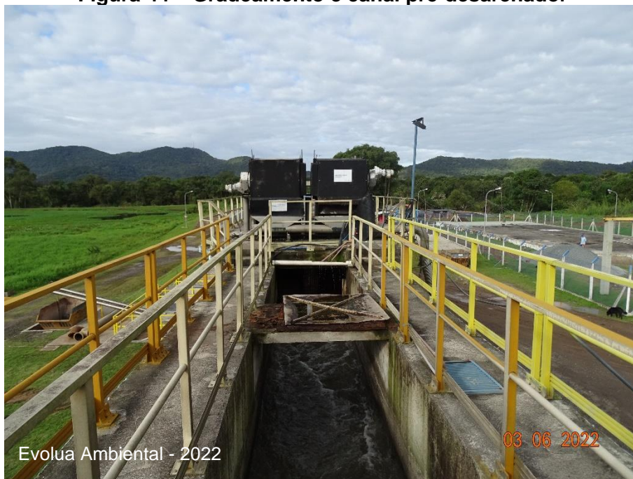
Figura 44 – Gradeamento e canal pré-desarenador
