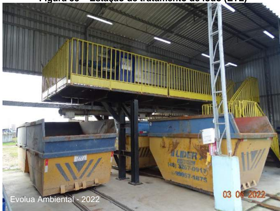
Figura 53 – Estação de tratamento de lodo (ETL)
