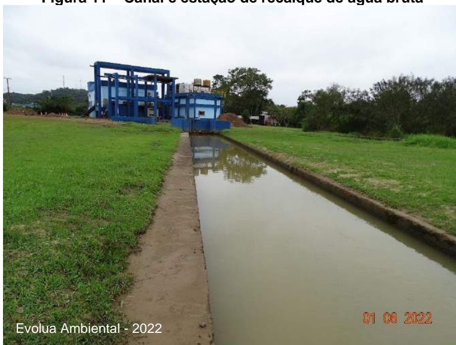
Figura 11 – Canal e estação de recalque de água bruta
