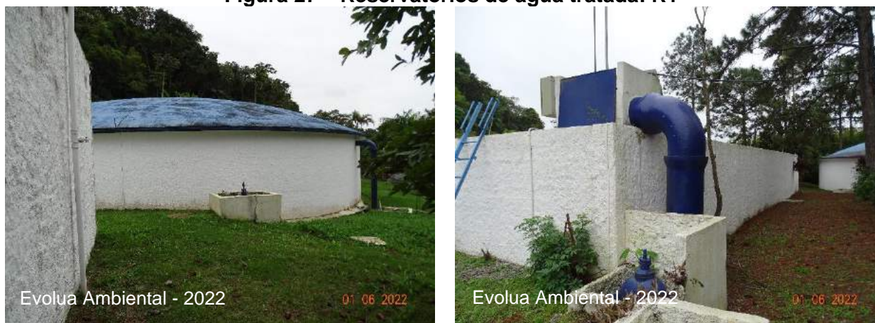
Figura 27 – Reservatórios de água tratada: R1
