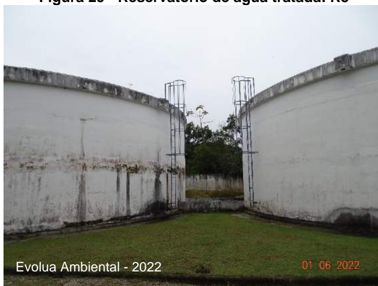
Figura 29 - Reservatório de água tratada: R3
