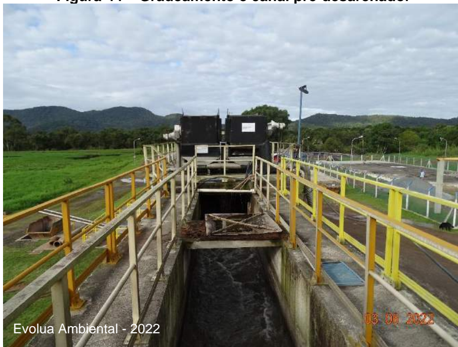
Figura 44 – Gradeamento e canal pré-desarenador
