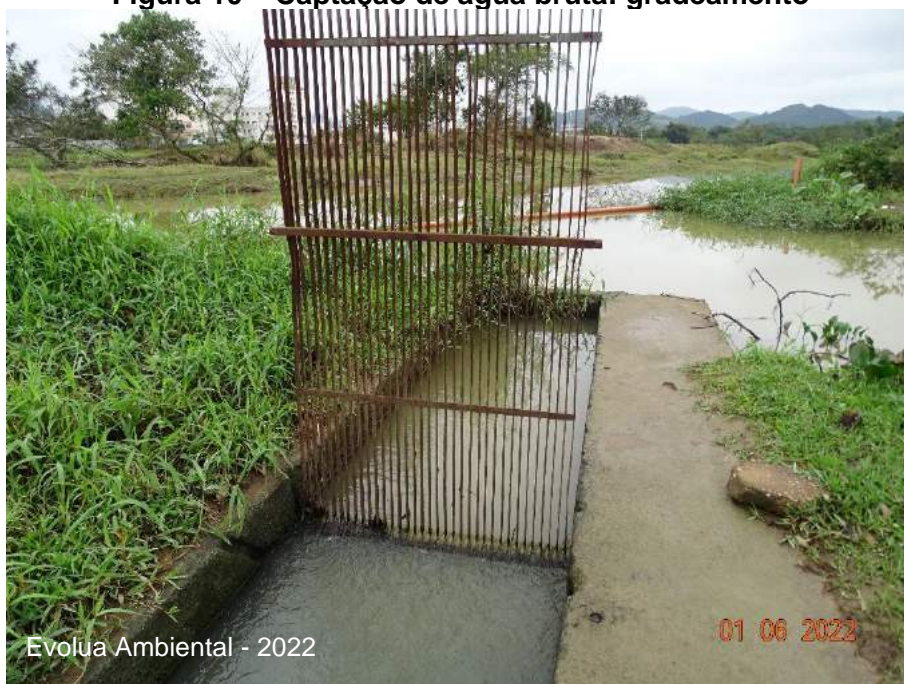
Figura 10 – Captação de água bruta: gradeamento
