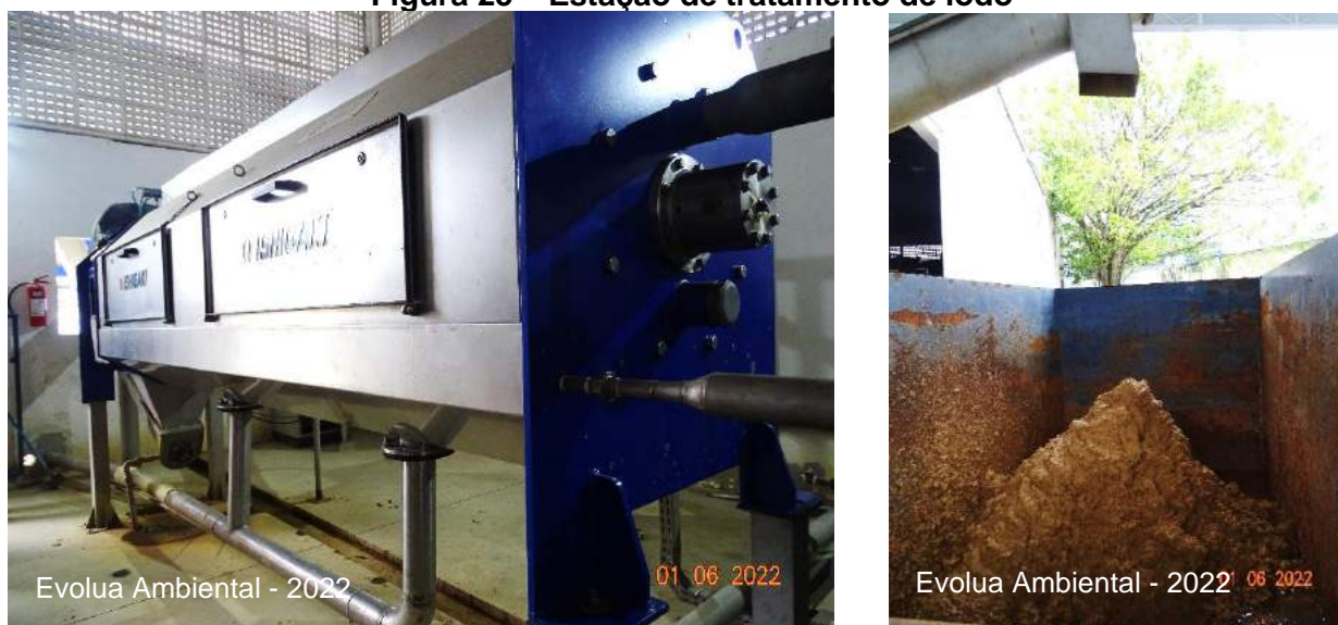
Figura 25 – Estação de tratamento de lodo
