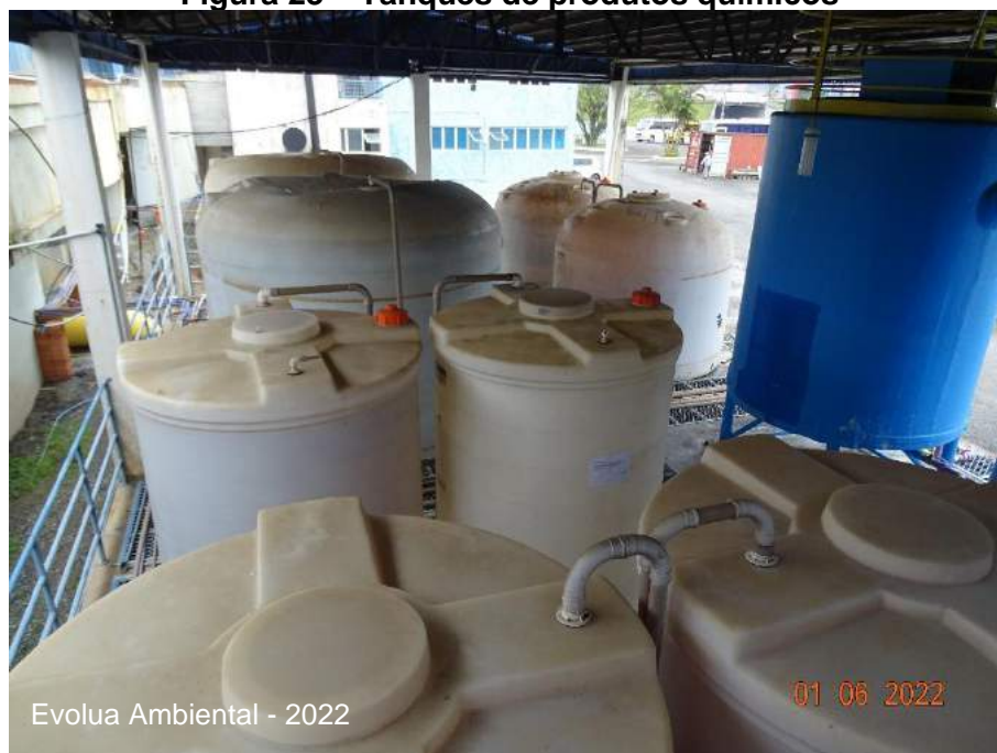
Figura 23 – Tanques de produtos químicos
